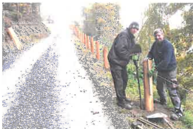
Holzleitschienenprojekt St. Leonhardstraße wurde vom Bauhof (Maxi Weiß u. Robert Hofer) erfolgreich umgesetzt.
